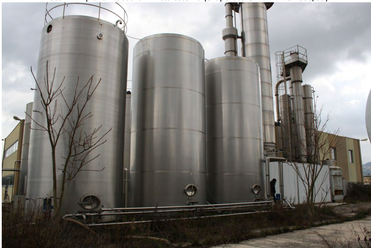
foto 2 - impianti industriali - vista esterna (evaporatore TVR FARCK 800/35)
