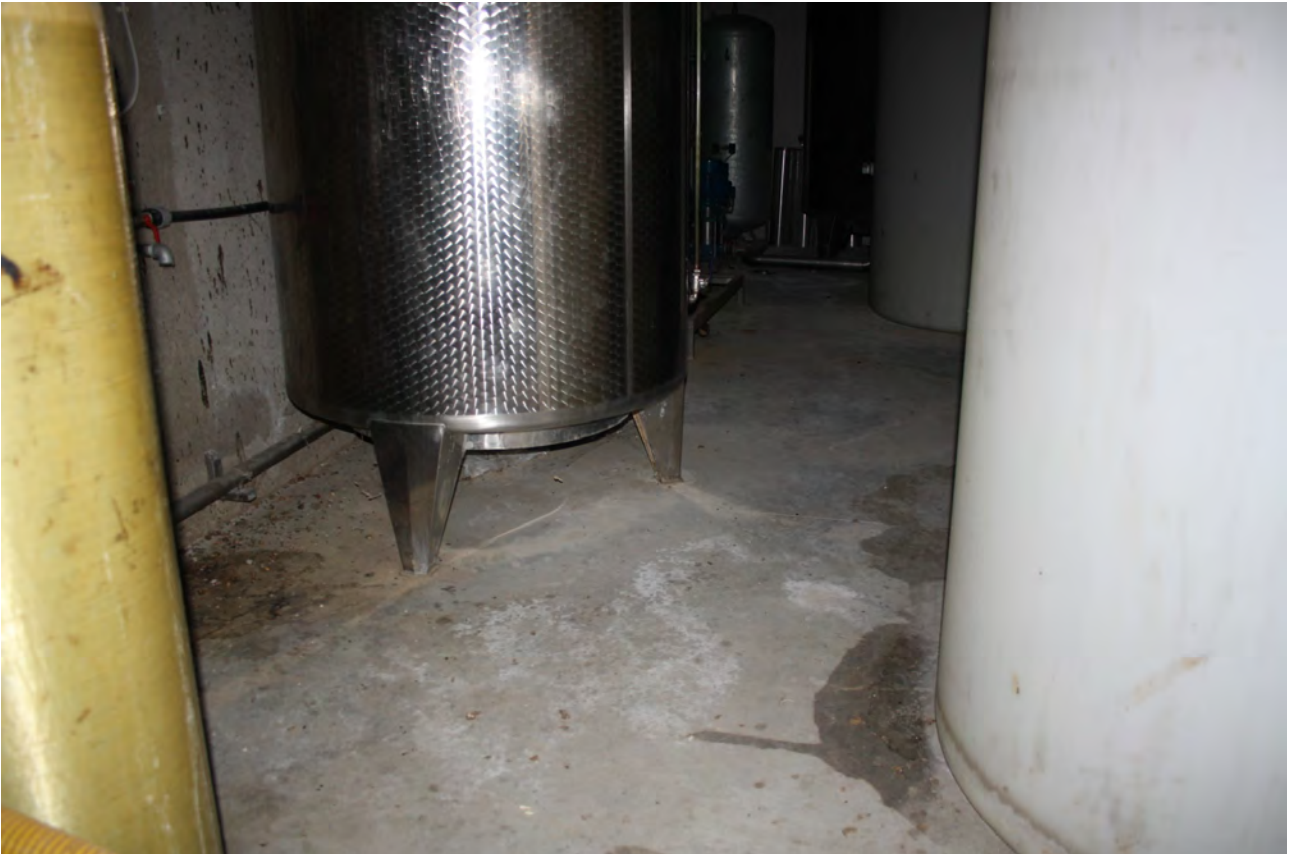
foto 10 - impianti industriali - vista interna
