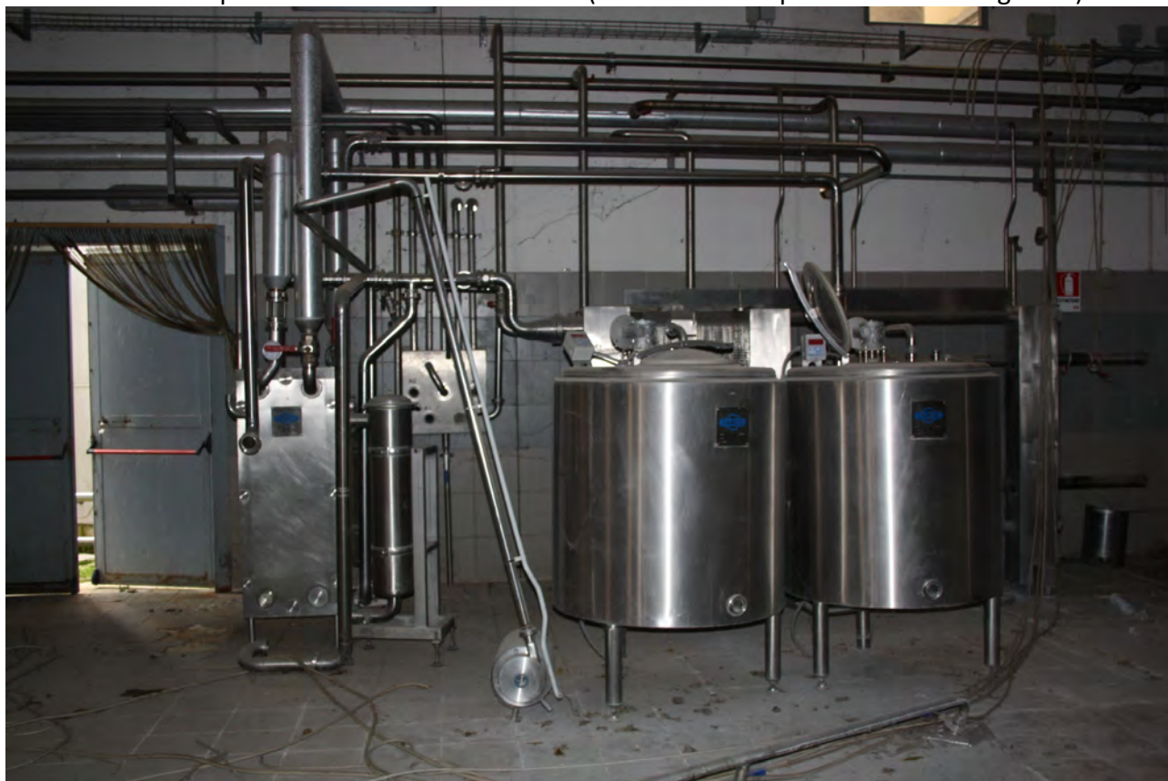
foto 7 - impianti industriali - vista interna (scrematore - separatore - centrifugatore)
