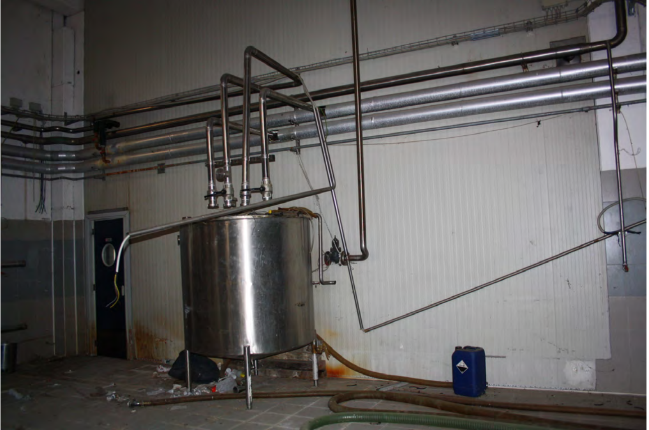
foto 9 - impianti industriali - vista interna
