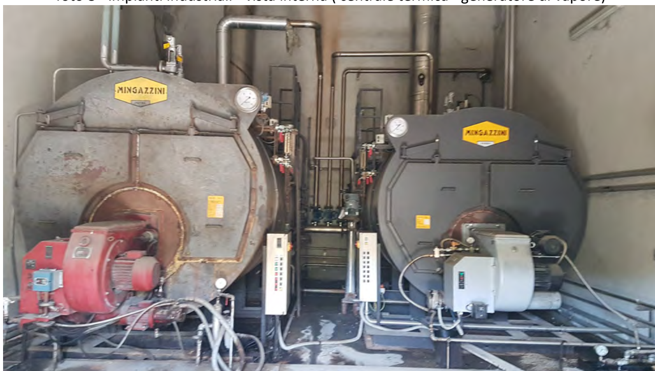
foto 8 - impianti industriali - vista interna (centrale termica - generatore di vapore)
