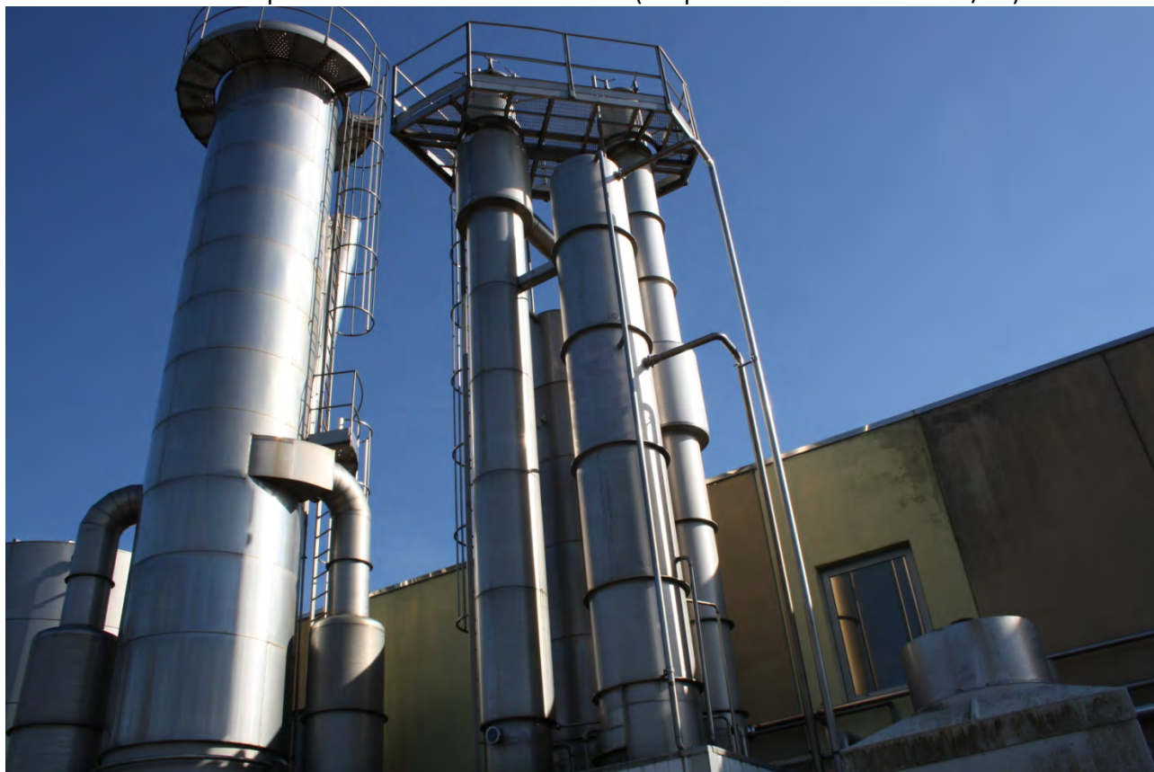
foto 1 - impianti industriali - vista esterna (evaporatore TVR FARCK 800/35)
