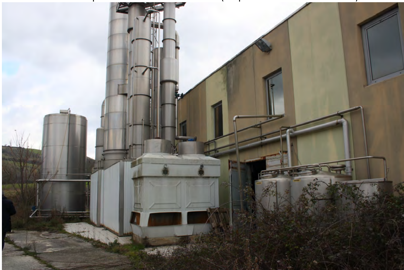
foto 3 - impianti industriali - vista esterna (evaporatore finitore + flash cool)
